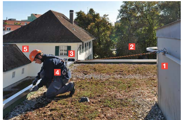
Bild 11 Rückhaltesystem auf einem Flachdach
