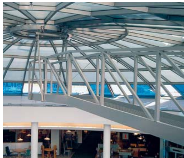
14 Fahrbare Brücke in rundem Gebäude. Von dieser Einrichtung aus können Deckeninnengläser gereinigt und allgemeine Instandhaltungsarbeiten ausgeführt werden.
