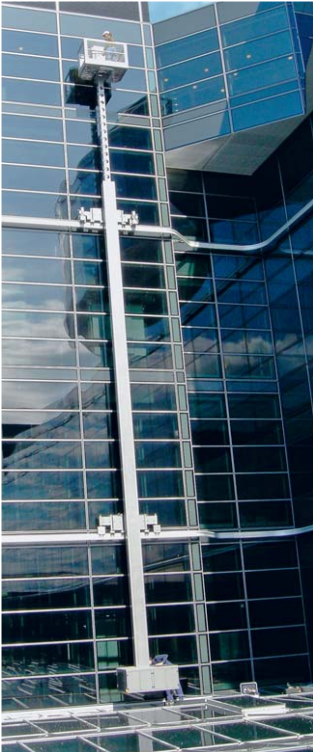
13 Mastbefahranlage mit Arbeitsbühne auf vertikalem Teleskopmast für das Reinigen der Gebäudeverglasung.
