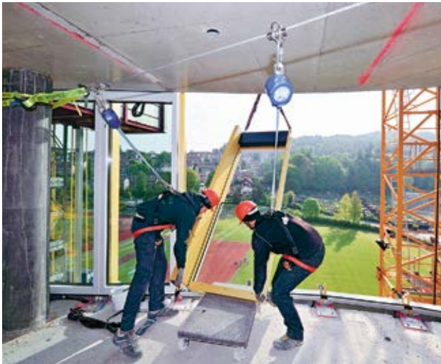
24 Arbeiten an einer Absturzkante.
