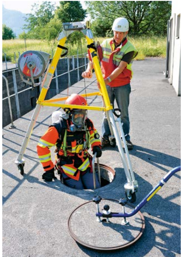
20 Einstieg in einen Schacht über eine Leiter. Sicherung durch Auffanggurt und Höhensicherungsgerät mit Rettungskurbel. Der Eingestiegene kann jederzeit von aussen mit der Rettungskurbel hochgezogen werden.
