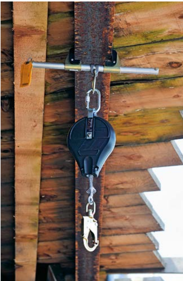
22 An mobilem Anschlagpunkt montiertes Höhensicherungsgerät.
