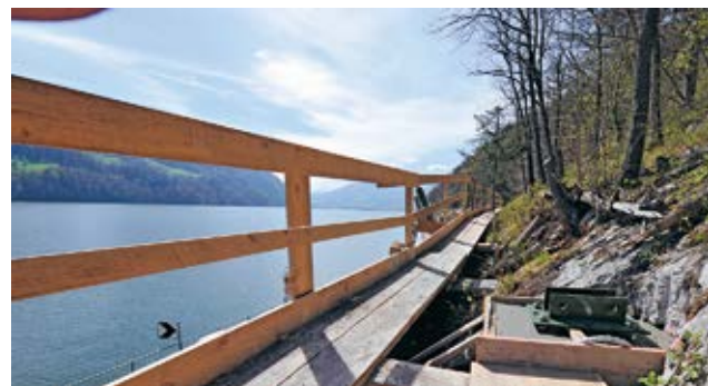
30 Bei umfangreichen Arbeiten im Gelände (z.B. Felssicherung) müssen die Zugänge zu den Arbeitsplätzen sicher gestaltet werden. Der Seitenschutz ist den Gegebenheiten angepasst zu erstellen (gemäss Bauarbeitenverordnung [BauAV] Art. 15 und 16).
