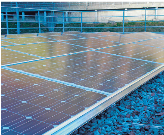
Bild 4 Solaranlage auf Flachdach mit umlaufendem permanentem Geländer
