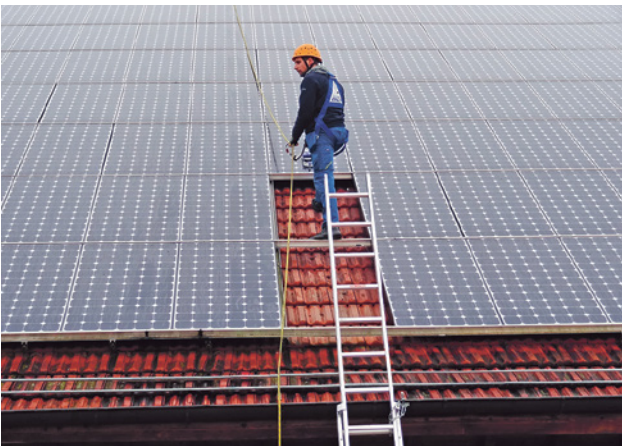
Bild 18 Überwurfseil, mit einem Mitläufer gesichert
